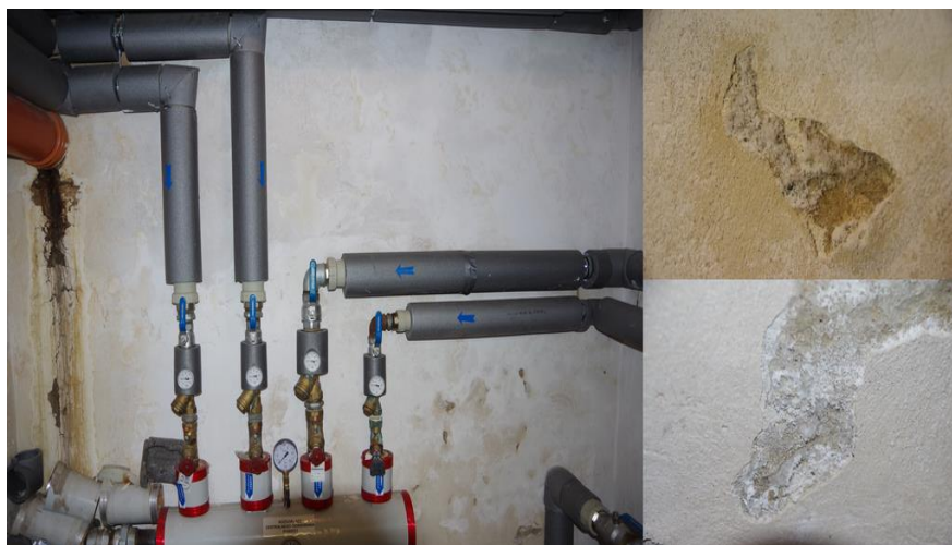
Fot.1 Widok na zawilgoconą przegrodę. Po prawej zbliżenie na miejsca z ubytkami tynku ( autor J. Szczepaniak)
